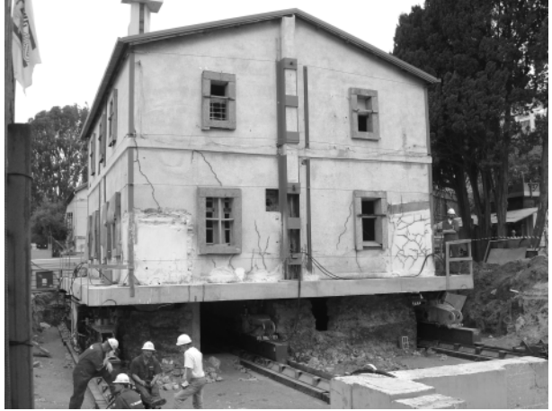
Unter Denkmalschutz gestelltes Templerhaus von Sarona beim Verschieben an den neuen Standort Foto: N.Szmuk
